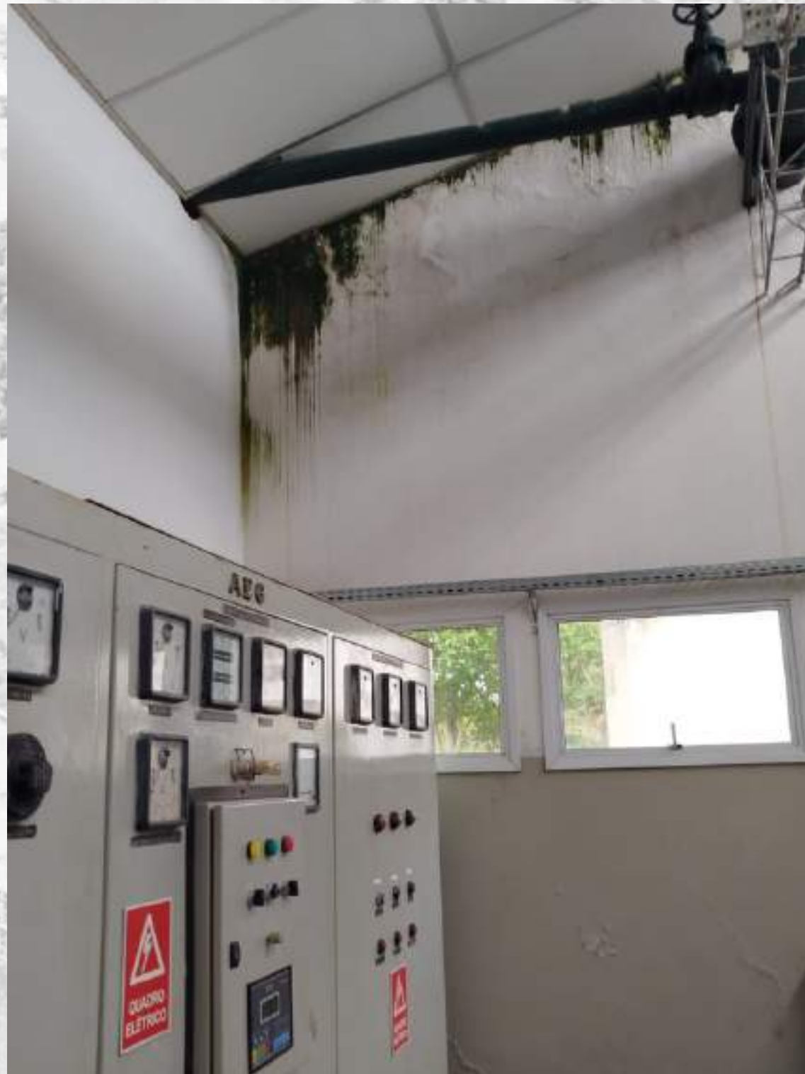
ANTES - REPARO DE TELHADOS E PINTURAS
