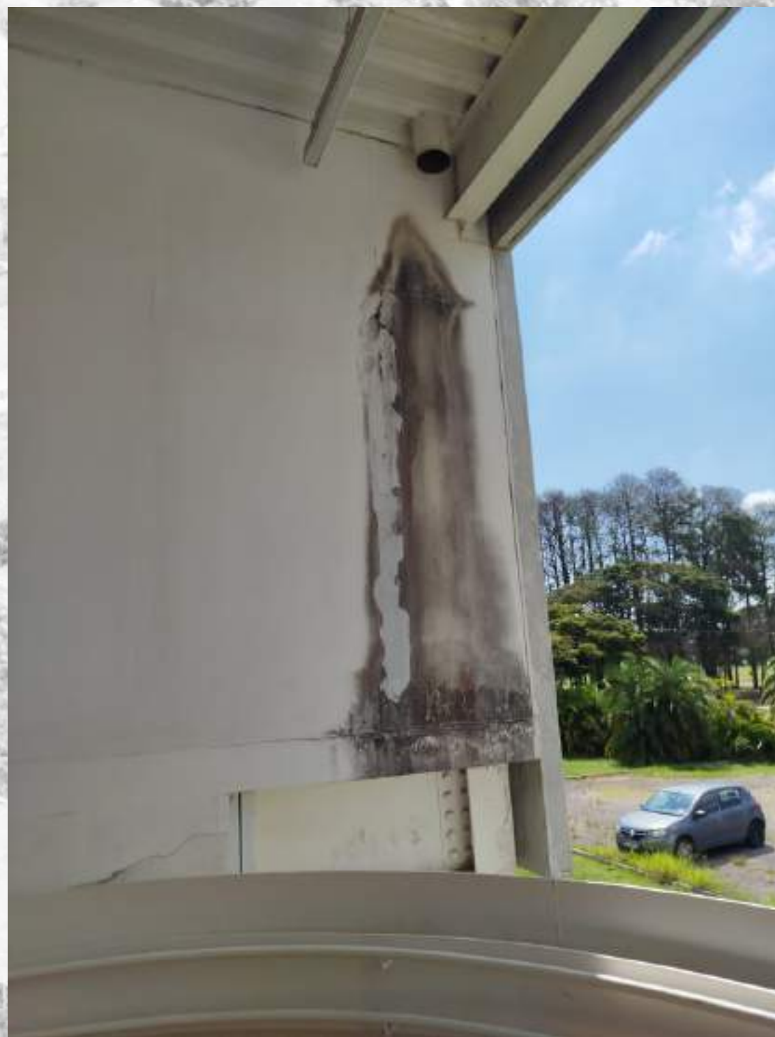
ANTES - AUSÊNCIA DE DESCIDAS DAS CALHAS
