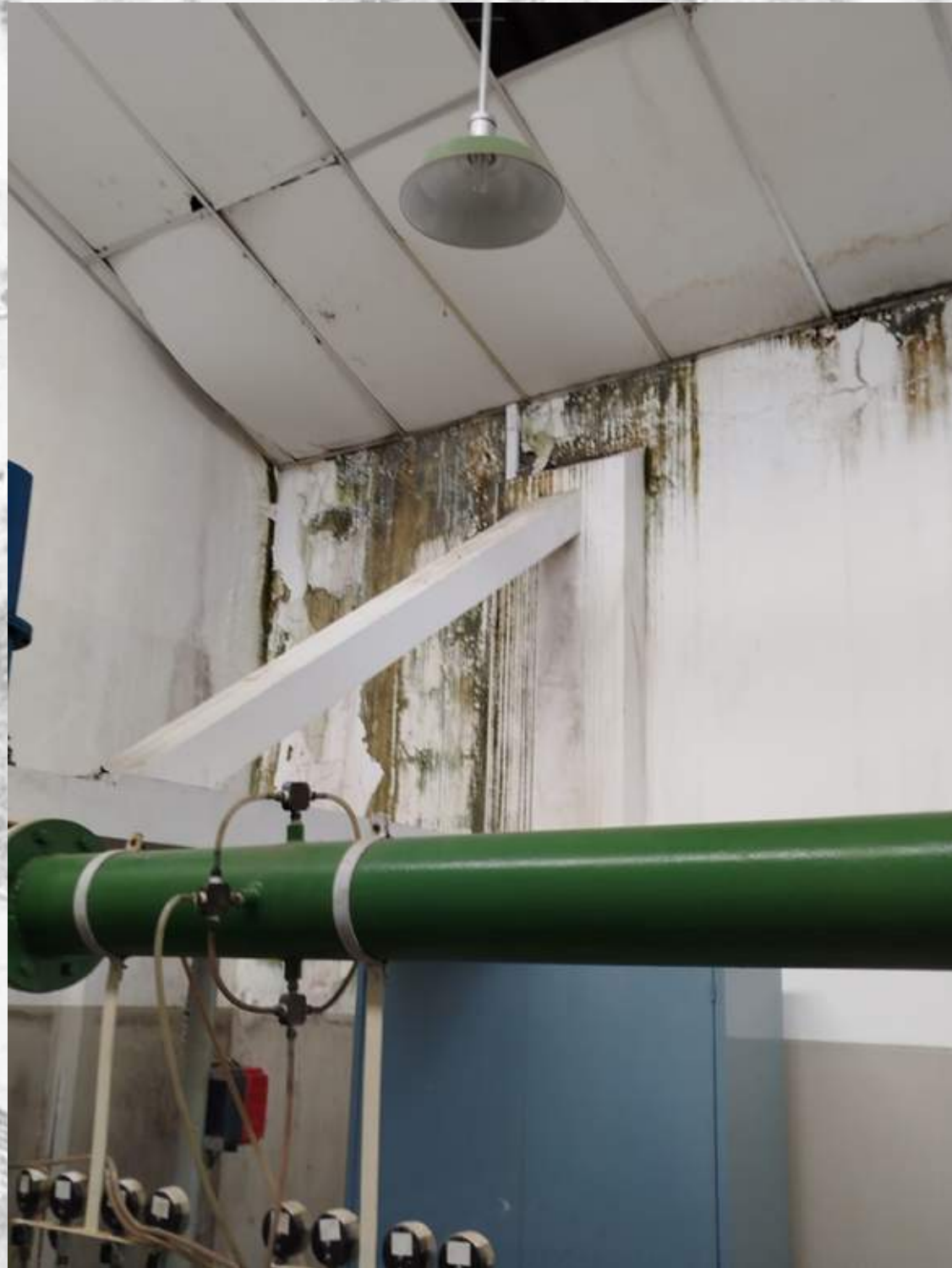
ANTES - REPARO DE TELHADOS E PINTURAS
